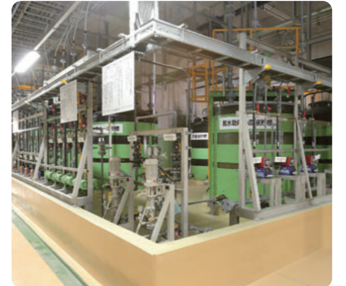
8 薬品注入設備
