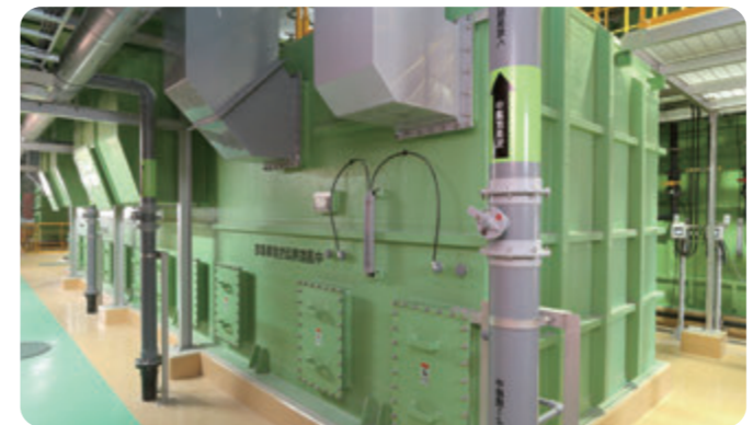
11 中濃度用活性炭吸着塔
