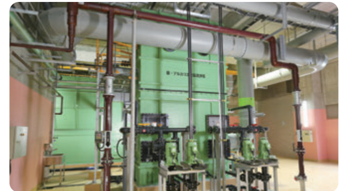
10 酸・アルカリ次亜塩洗浄塔
